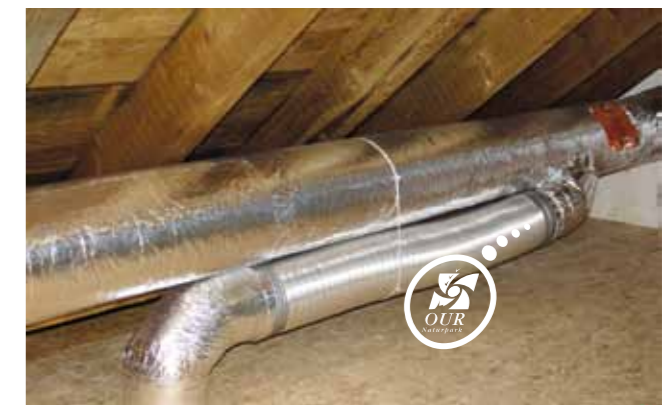
Luftleitungen mit Schalldämpfer
