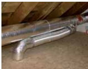
Verteilungsrohre der Komfortlüftung
