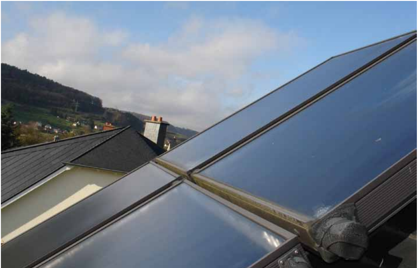
Flachkollektor – thermische Solaranlage
