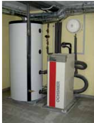
Wärmepumpe mit Warmwasserboiler
